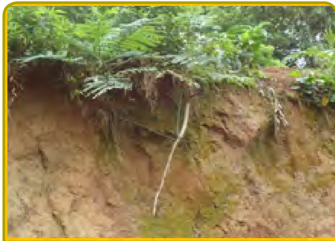
Deslizamientos de taludes en las vías
