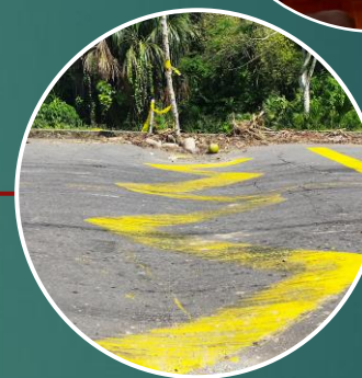
ESTADO DE CALZADA
